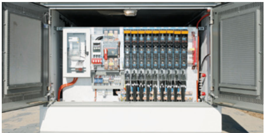
▲ Eigen trafostation voor de megawatt fotovoltaïsche installatie
